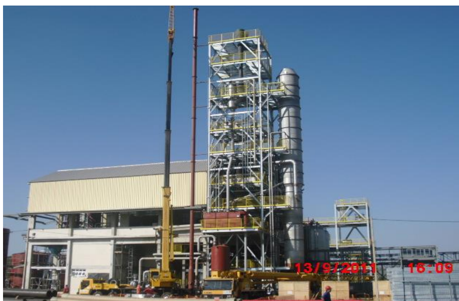
Foto 1.5: Coluna de destilação molecular: Equipamento sendo instalado a direita da torre da refinaria. Fonte: Fabricante Alfa Laval.
