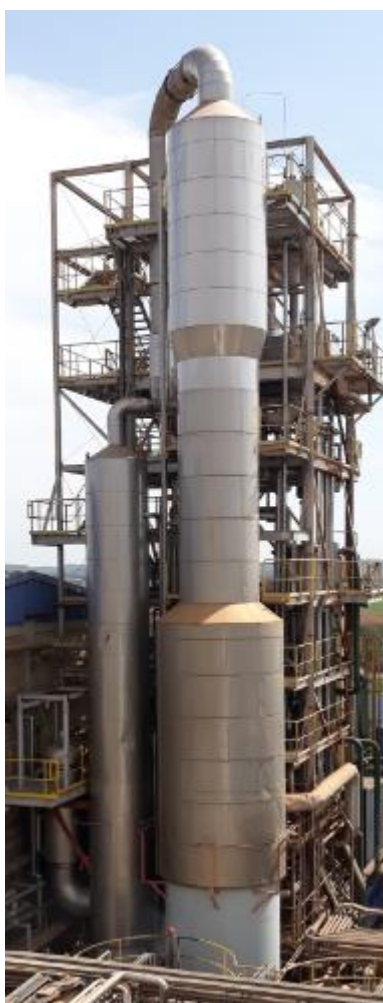
Foto 5.1: Desodorizador (equipamento inferior apresentado a direita na foto) fabricante Alfa Laval com capacidade de produção nominal de 600 toneladas/dia, acoplado com um “double scrubber” (equipamento superior à direita na foto) para melhor aproveitamento de ácido graxos. Concentrador Tocoboost® do fabricante Alfa Laval (equipamento inferior apresentado a esquerda da foto). Fonte: Autor .
