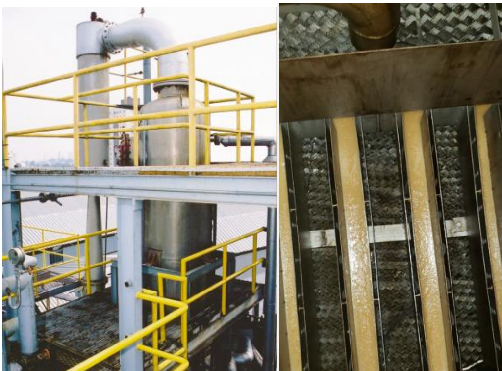
Foto 5.5: a) Scrubber; b) recheio. Fonte: a) Material Técnico da Alfa Laval; b) Autor
